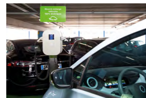
Borne de recharge électrique
